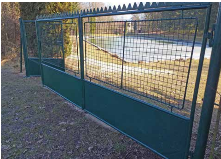
Repasovaná vrata a vrátka do areálu požární nádrže
